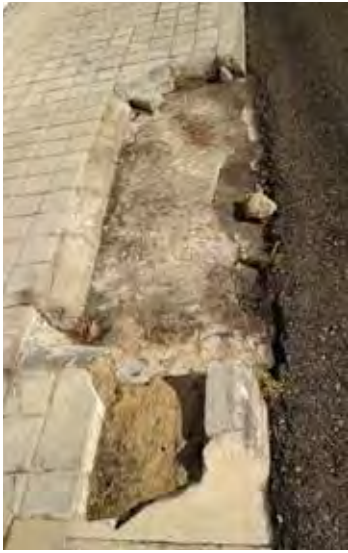
Estado de la acera en la c/ Escorial, 8
