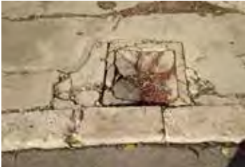
Socavón en la c/ Sta Caterina
