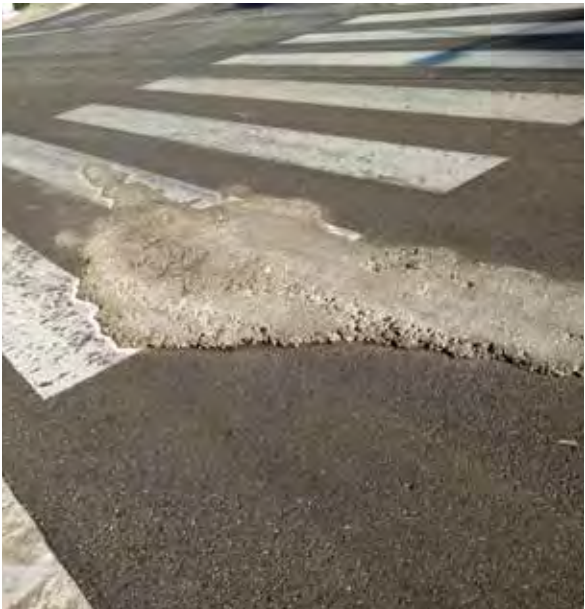
Desnivel sobre calzada en la Avda. Sta Apolonia, 21
