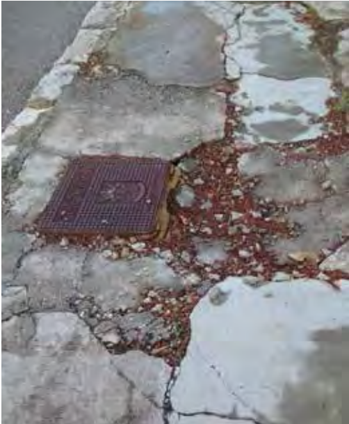
Estado de la acera en la c/ Mariano Benlliure, 3
