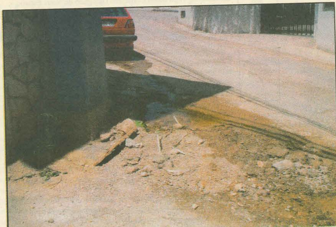
Donde antes hubo una calle ahora hay escombros y escapes de agua provenientes de tuberías rotas, que no terminan de arreglar...
