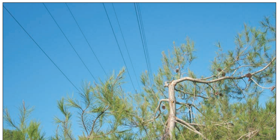
El problema de los tendidos eléctricos y la vegetación.
