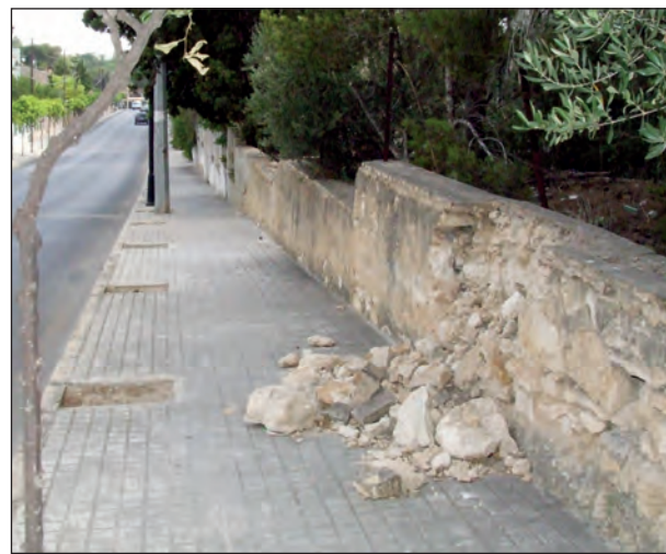
Av. San Lorenzo - Muro derruido.
