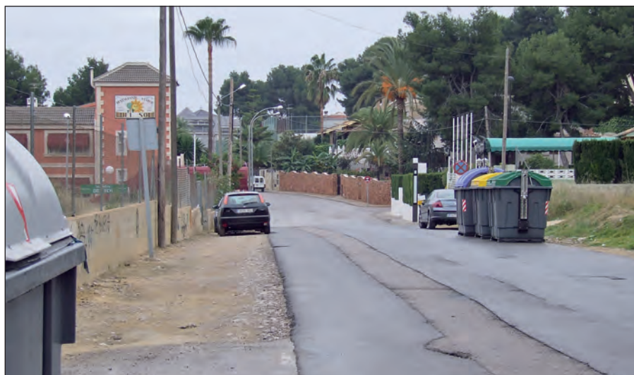
Aspecto actual del deterioro de la calle del Sol.
