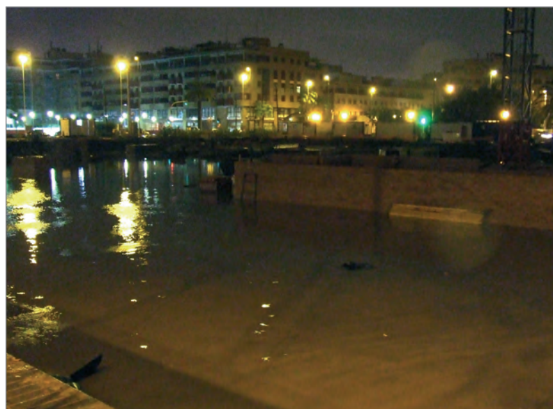
Inundación, por las lluvias, de las obras del aparcamiento de la entrada a Torrent.
