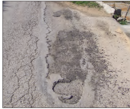
Hundimiento del asfaltado al final C/Alfons el Savi.
