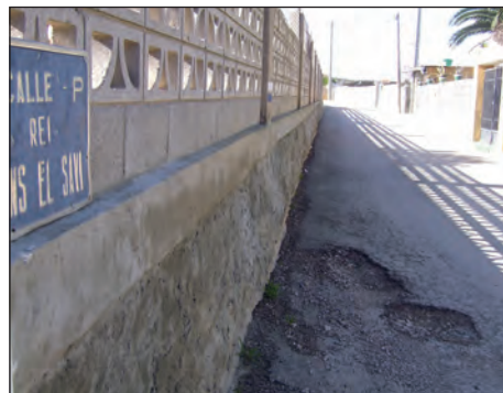
C/Alfons el Savi, agujeros en el asfalto.
