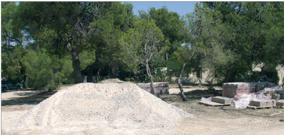
El monte público asolado por las obras.
