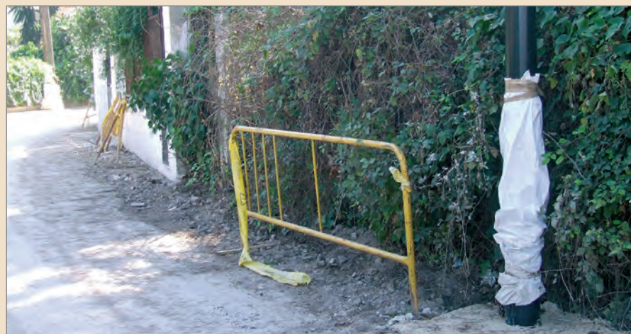
C/ Virgen de Guadalupe: la empresa de instalación de alumbrado la ha dejado de esta guisa.
