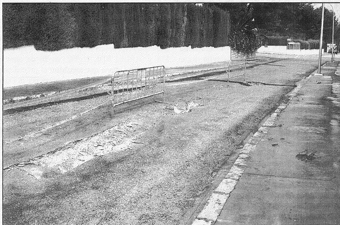
El deficiente asfaltado se hunde con las lluvias
