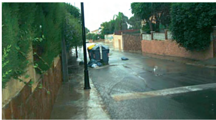
C/ Ademuz, 7: la propiedad siempre queda anegada cuando llueve con intensidad.
