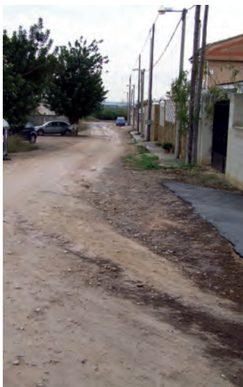
C/ Puzol, sin asfaltar.
