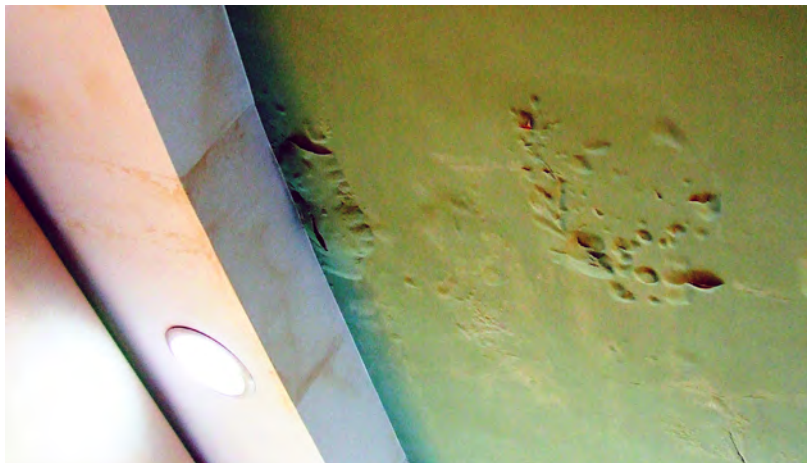
En la ‘Sala de Ordenadores’ las goteras han dañado dos equipos.
