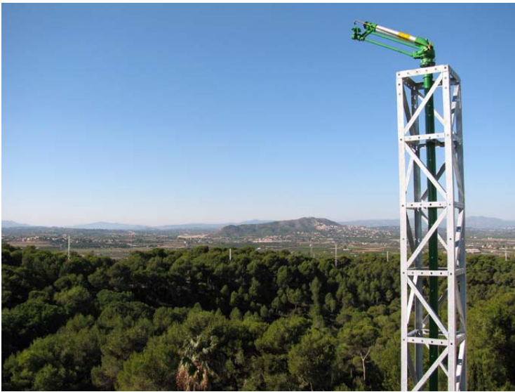
Cañón de agua del SIDEINFO de El Vedat.
