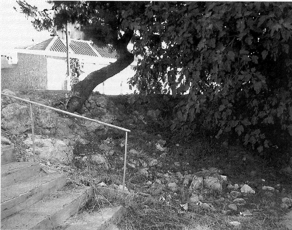
La basura se acumula en el acceso al Barrio La Concepción
