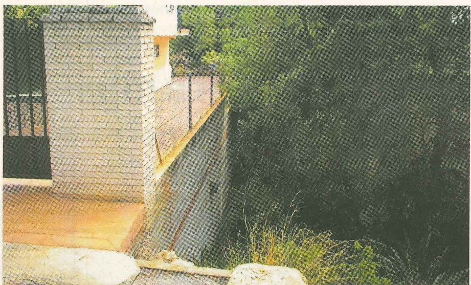
Altísimo riesgo de incendio: calle Mossén Sorell
