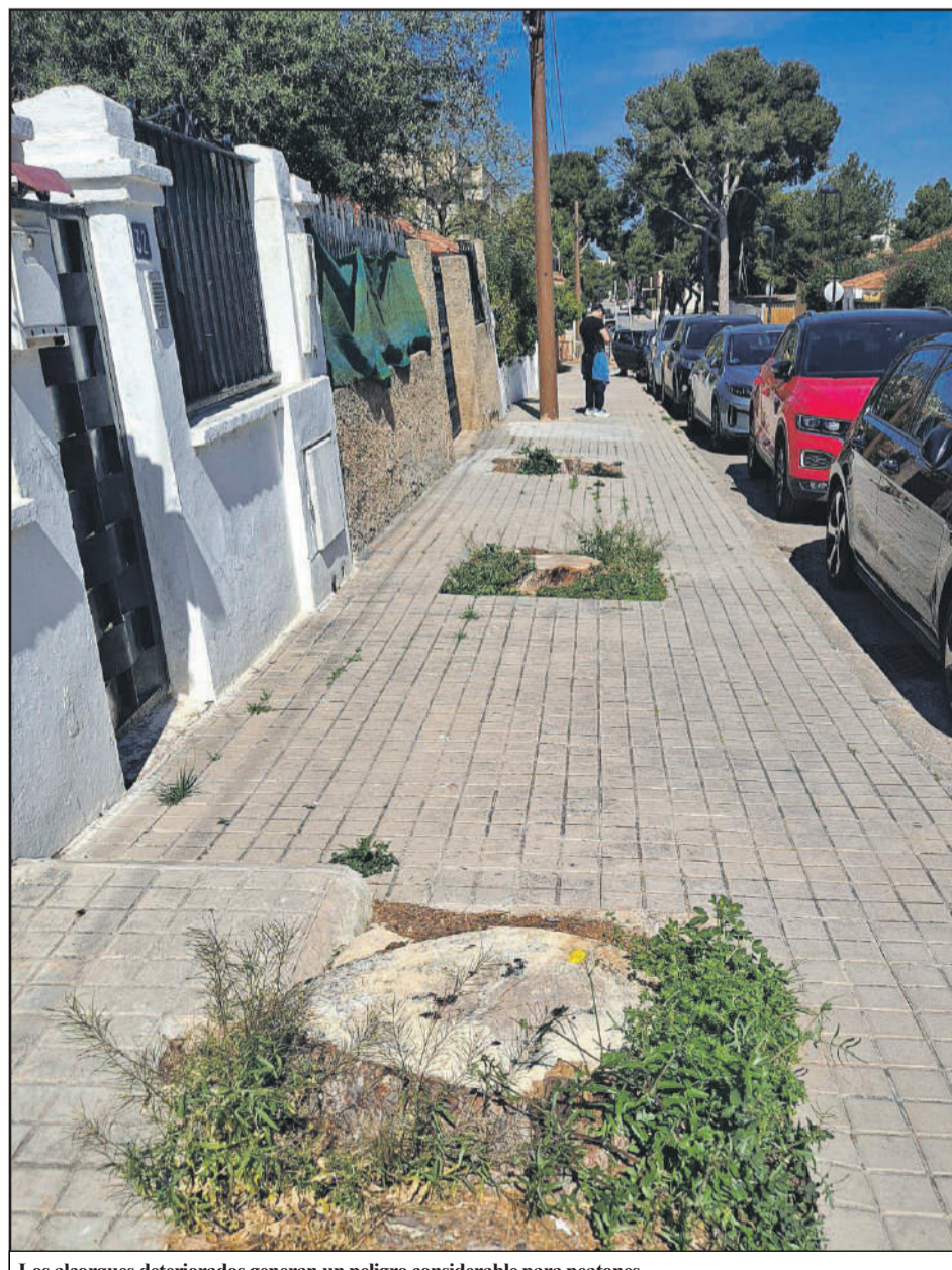
Los alcorques deteriorados generan un peligro considerable para peatones.
